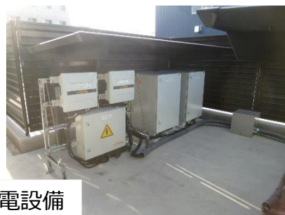
太陽光発電設備
